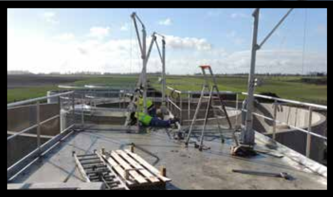
Agent de station d'épuration (chantier d'Urvilliers)
