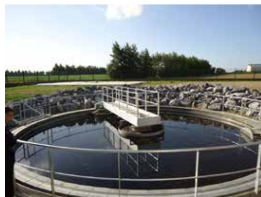
Eaux de process d'épuration - Station de Marcelcave (80)
