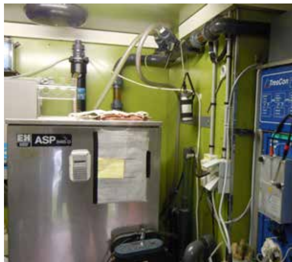
Intérieur d'une station de mesure automatique
