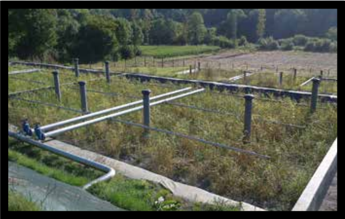
Station de dépollution à filtres plantés de roseaux de Fieffes Montrelet Bonneville
