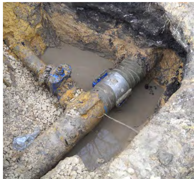
Fuite sur un réseau d'eau potable
